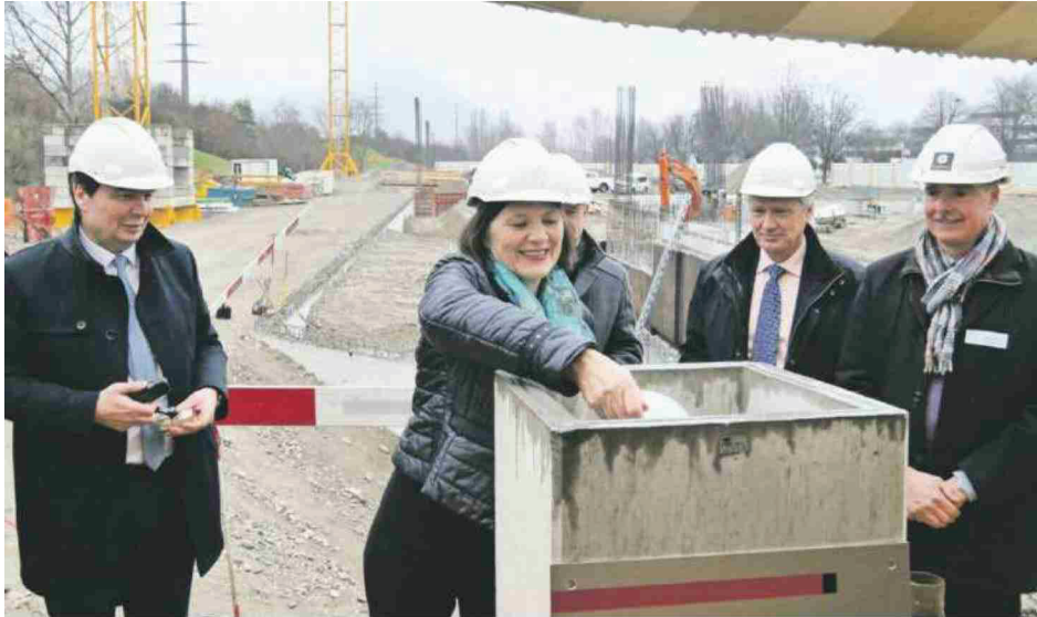
Mehr Parkplätze. Staatsrätin Esther Waeber-Kalbermatten bei der symbolischen Grundsteinlegung für das neue Parkhaus beim Spital Sitten.
